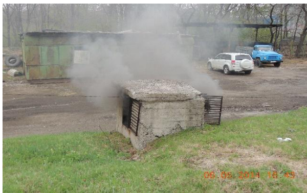
Рисунок 5.37 – Выход дыма из вентиляционной шахты при горении кабельной продукции
