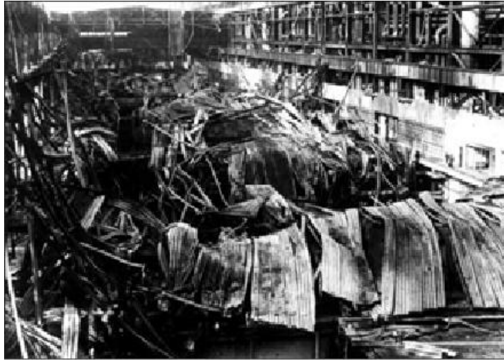
Рисунок 1.8 – Результат обрушения металлических строительных ферм из-за воздействия пожара
