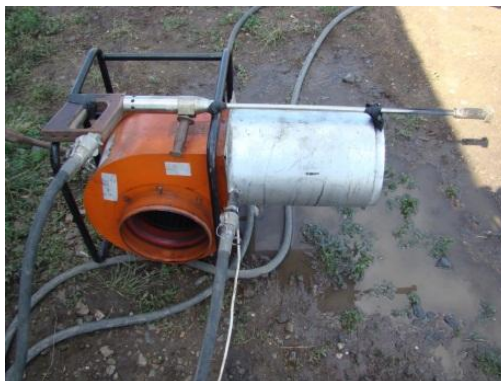
Рисунок 5.53 – Общий вид окончных устройств установки подачи ВСМФС
